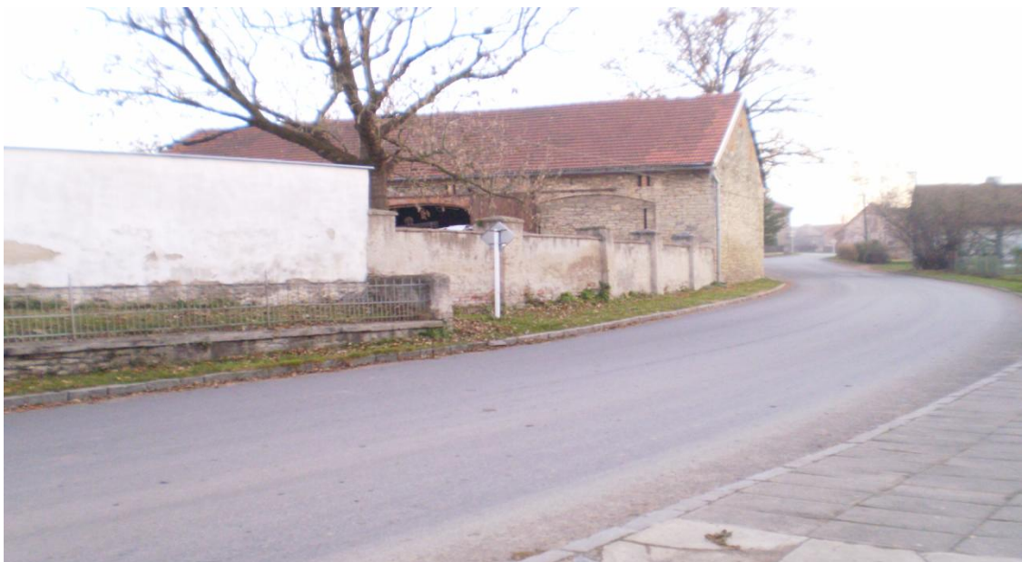
Fotografie: Poškozená zeď spojující budovu OÚ s obecní stodolou
