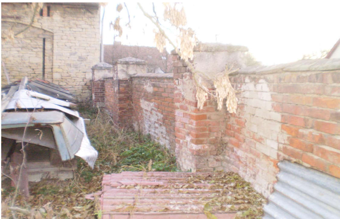
Fotografie: Poškozená zeď spojující budovu OÚ s obecní stodolou
